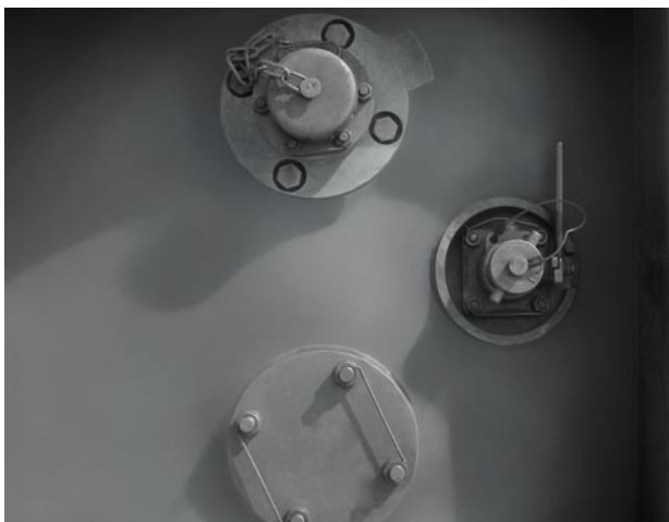
Фото №3. Контейнеры Kemira оснащены с предохранительными клапанами и устройствами. Конструкции, имеющие длительный контакт с перекисью водорода, рекомендуется выполнять из марок стали AISI316L и AISI304L.
